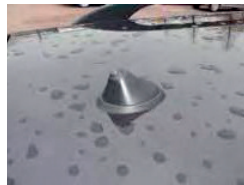
Een ontbrekende of verwijderde antenne
